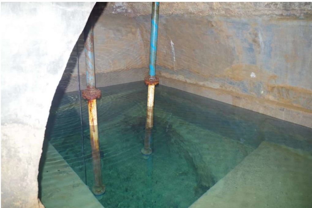
Figure 6 : Vue de la chambre de pompage (Source : SAFEGE 2014)
